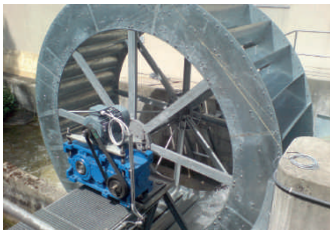
ansicht des getriebes mit dem generator
